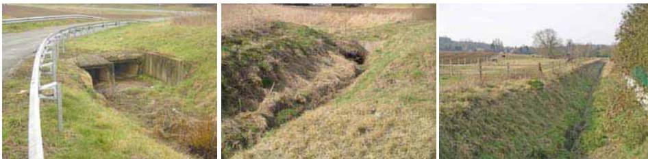
Fossés d'écoulement des eaux
